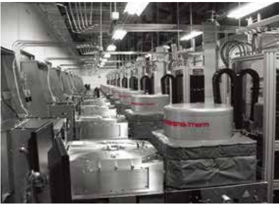
位于美国北卡罗莱纳州Greensboro的RFMD公司已经安装了多台 LAPECVD 设备
